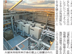
久留米市役所庁舎の屋上に設置されたガスコージェネ
