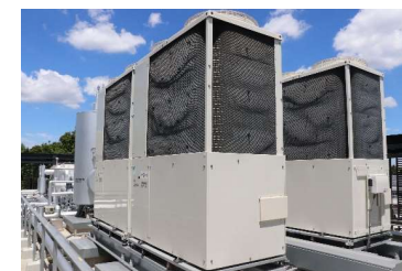
GHP 2027kW (計32台)
