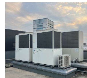
高効率GHP 224kW (停電対応型56kW×2台、標準型56kW×2台)
