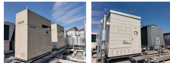
(左) コージェネ 70kW (35kW×2台) (右) 排熱投入型吸収冷温水機 390kW
