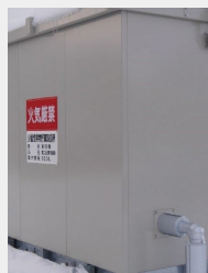
非常用発電機(軽油)
