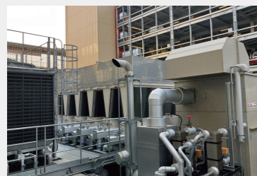
電気空調設備
