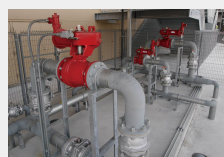
中圧ガス緊急遮断弁
