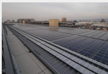
太陽光発電設備
