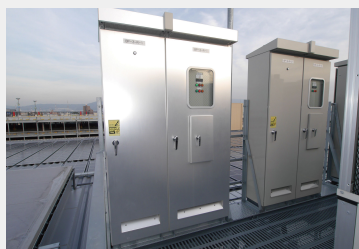
COOL分電盤(写真左)
