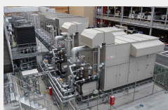
非常用発電機兼用コージェネ
