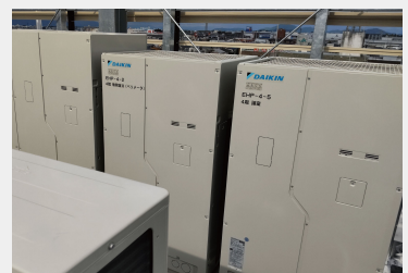
電気空調設備
