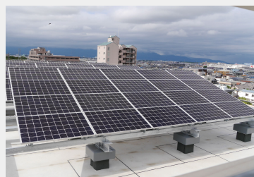
太陽光発電設備
