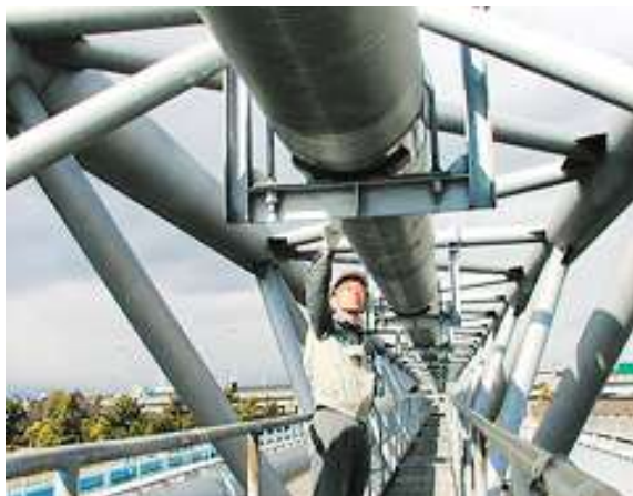
都市ガスパイプライン
